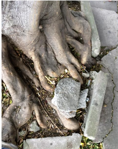
Figura 25. Raíces del Ficus benjamina provocando levantamiento de pavimento de banqueta en la 3ª calle de la zona nueve.
