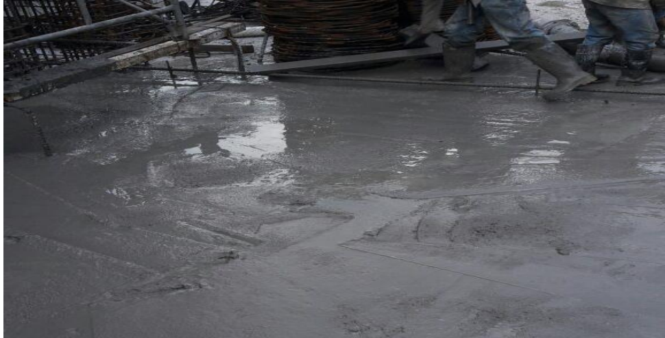
Figura 11: Agua de exudación en la superficie de concreto recién fundido en la losa.
