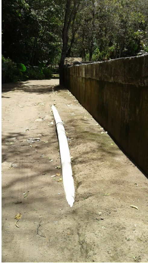
Figura 29. Línea de conducción, Ciénega I.
