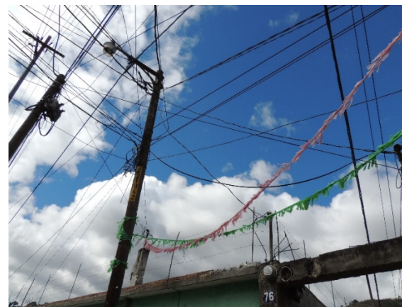
Alumbrado Electrico. San Bartolome Becerra. (2014). Fuente: Fotografía Propia
