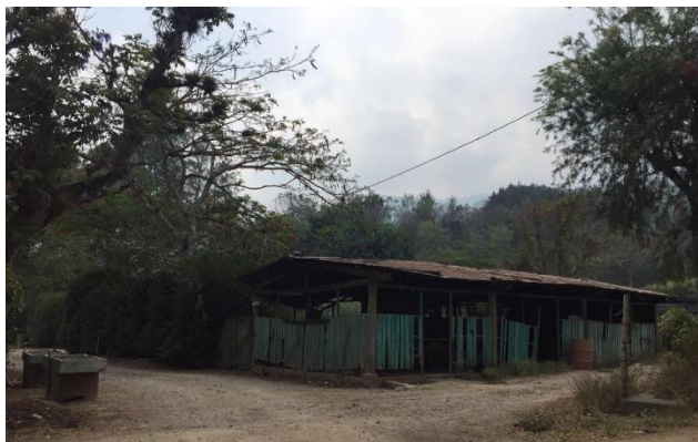
Terreno alledaño que cuenta con infraestructura en colapso.
