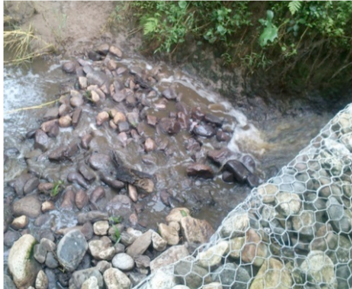
Figura 20. Flujo indeseado del efluente a través del gavión, por la parte inferior del mismo.
