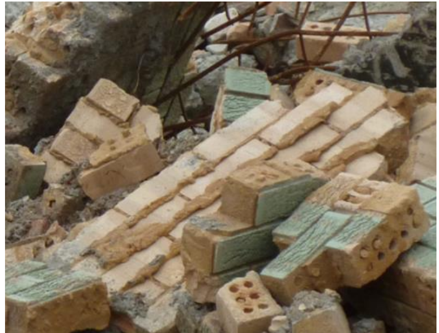
Fotografía 13. Residuos comunes de block de concreto y pómez en proyectos de demolición.
