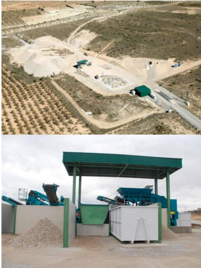
Fotografía 8. Instalaciones de planta de Baza, España.
