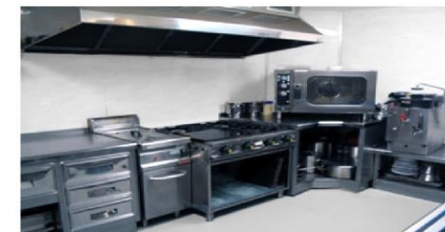
Cocina de restaurante en Ecuador.
