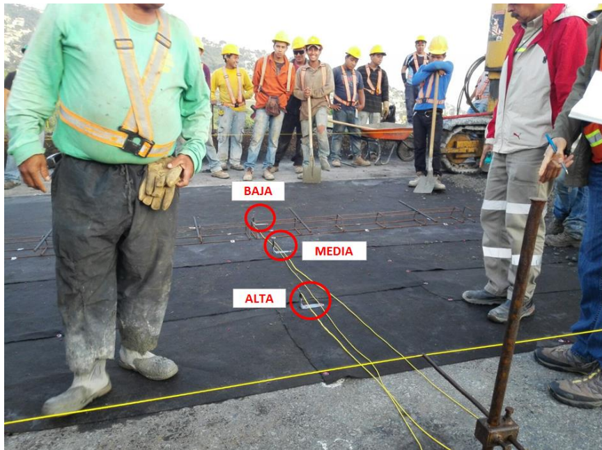
Figura 46: Colocación de los sensores de temperatura a diferentes alturas, en esta ocasión solo se colocó un dispositivo.
