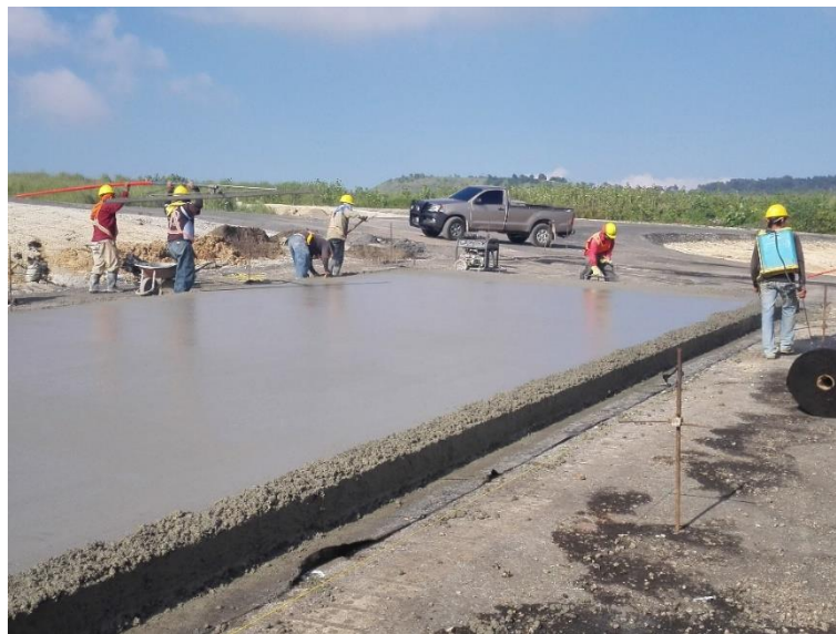
Figura 13: Exudación del concreto en la superficie del concreto recién colocado en una losa de pavimentación.
