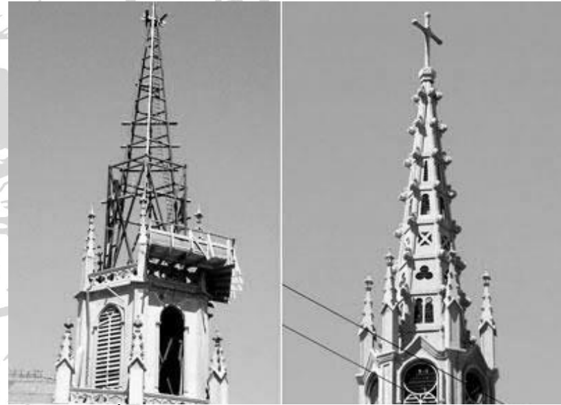
ILUSTRACIÓN 67: Proceso de fabricación de la torre principal de la Iglesia Los Carmelitas en Viña del Mar, Chile.
