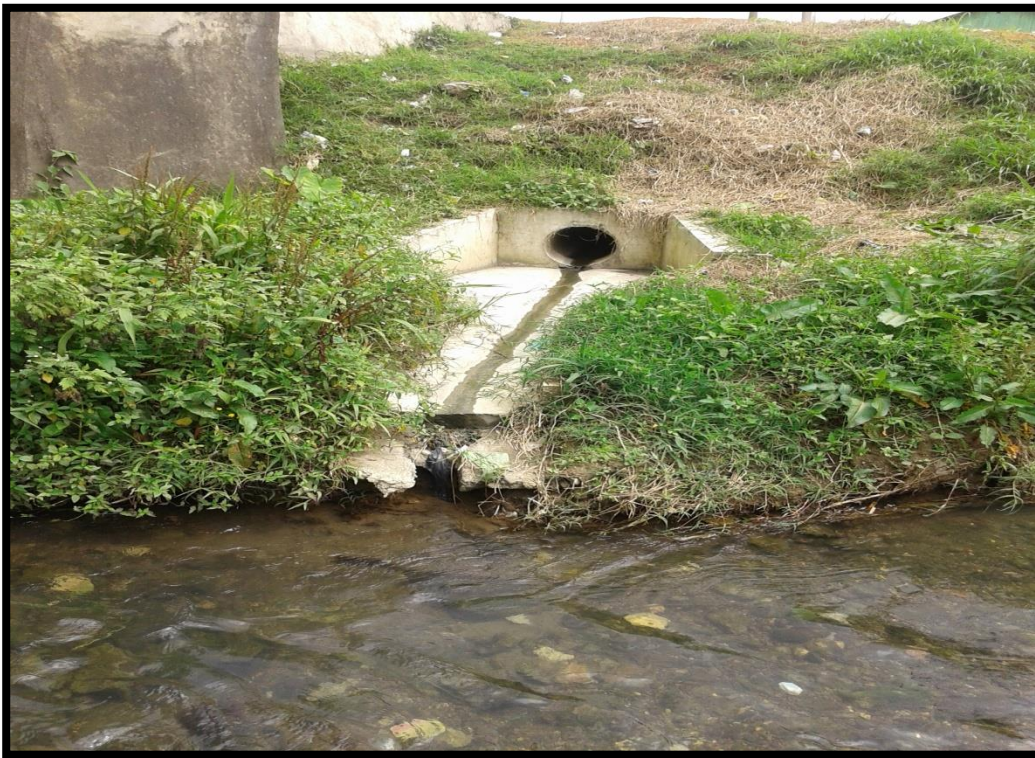
Figura 17. Salida de drenaje pluvial
