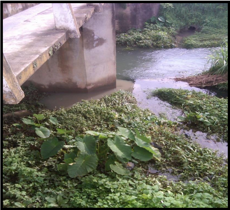
Figura 15. Salida de drenaje residual inundado
