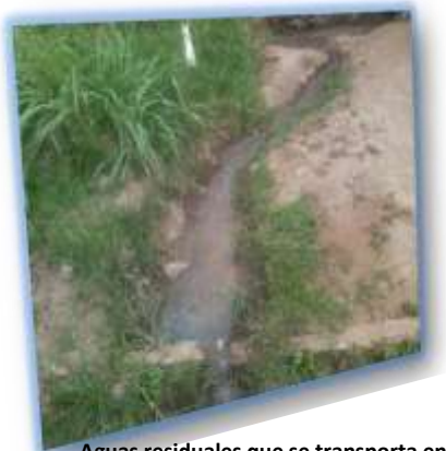
Aguas residuales que se transporta en las calles de Prados de Santa Rosa por no contar con drenaje.
