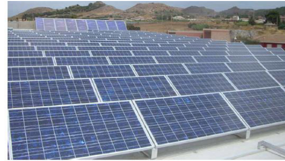
PANELES SOLARES EN CUBIERTAS
