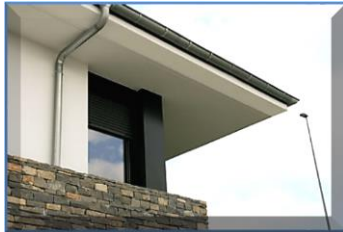
Fotografía 3 Alero en vivienda Febrero 2014
