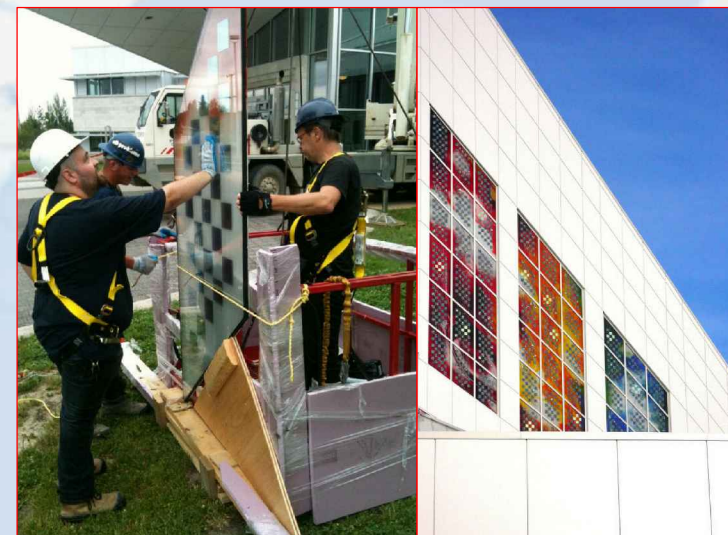
FOTOGRAFIA No. 27 VITRALES FOTOVOLTAICOS DE COLORES ESTOS VITRALES SE HACEN A LA MEDIDA YA QUE SON VITRALES CONFORMADOS DE VIDRIO DE SEGURIDAD + CELDAS FOTOVOLTAICAS. FEBRERO 2014 Fuente: http://nociticas.arquired.com.mx/shwArt.ared?idArt=1808
