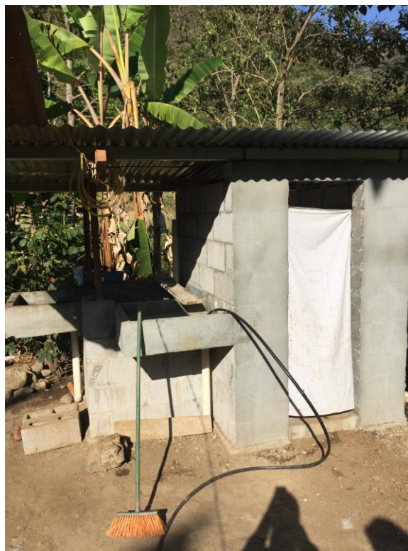
Duchas y pila de lavado de equipo para fumigación
