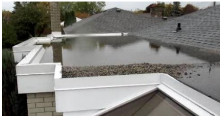
Imagen 30 - Techo inundado con agua de lluvia
