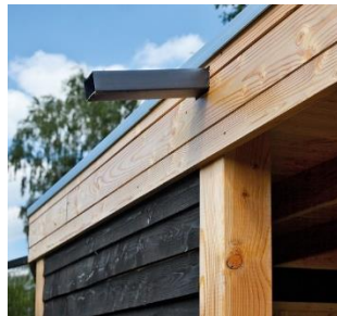
Imagen 31 - Agujero de salida de agua de lluvia en techo
