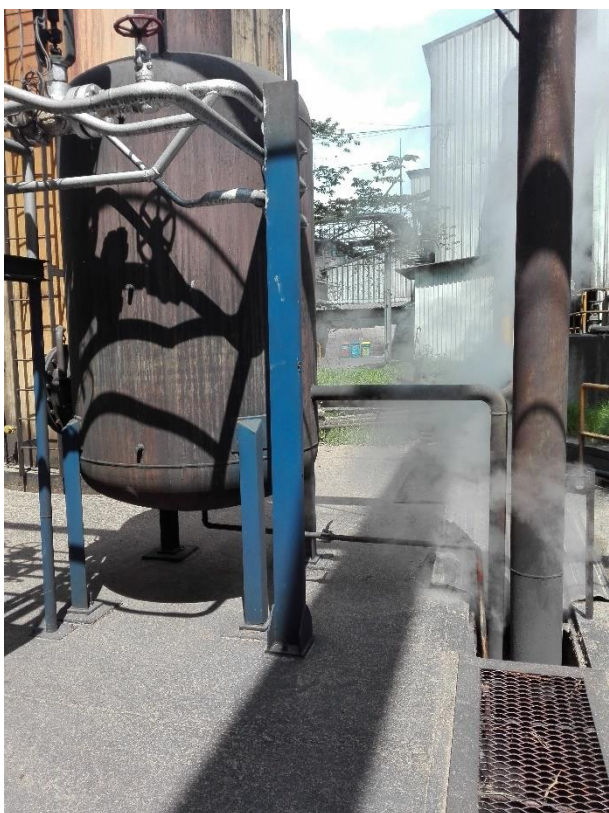
Imagen No. 29. Sistema de purga de caldera Fotografía: Elaboración propia.
