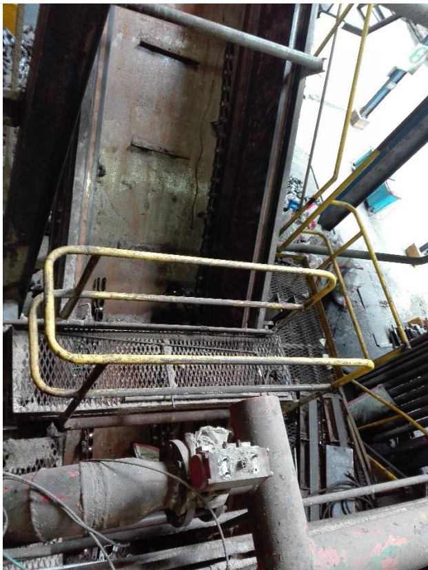
Imagen No. 14. Bandas transportadoras de bagazo de caña hacia caldera Fotografía por: Eduardo Sanabria.
