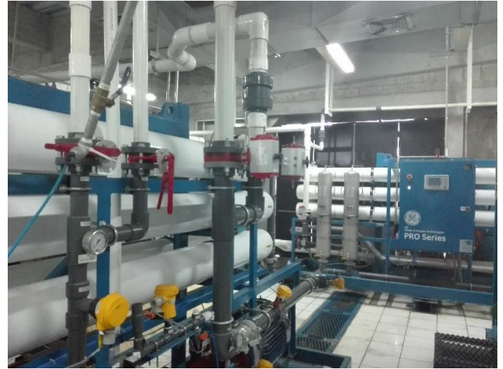
Imagen No. 17. Tratamiento de agua de caldera por osmosis inversa Fotografía: Elaboración propia
