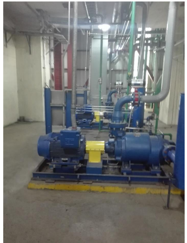
Imagen No. 19. Área de bombas de alimentación de caldera Fotografía: Elaboración propia.
