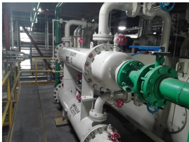
Imagen No. 28. Sistema de distribución de aceite para turbina Fotografía: Elaboración propia.
