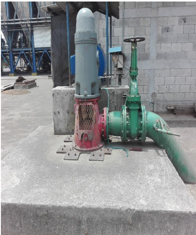
Imagen No. 18. Pozo de agua para caldera Fotografía: Elaboración propia.
