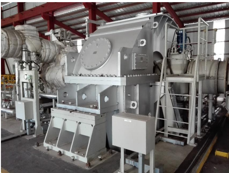
Imagen No. 25. Turbina condensing. Fotografía: Elaboración propia.
