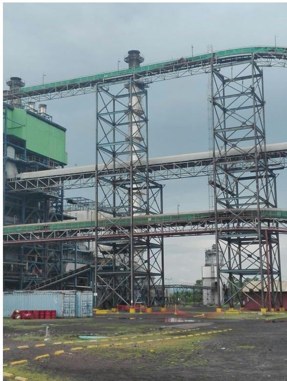
Imagen No. 27. Chimenea de caldera Fotografía: Elaboración propia.
