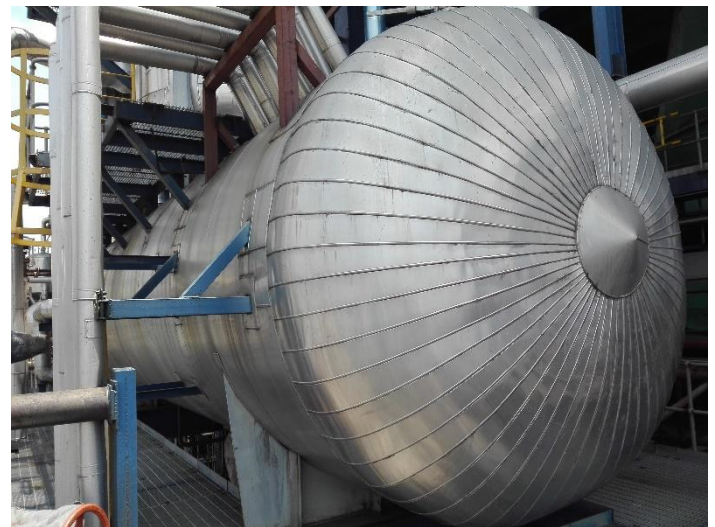
Imagen No. 23. Economizador de caldera Fotografía: Elaboración propia.
