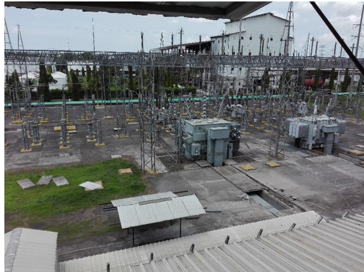
Imagen No. 26. Red de distribución de energía Fotografía: Elaboración propia.
