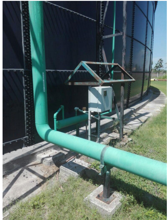
Imagen No. 36. Biodigestor Fotografía: Elaboración propia.
