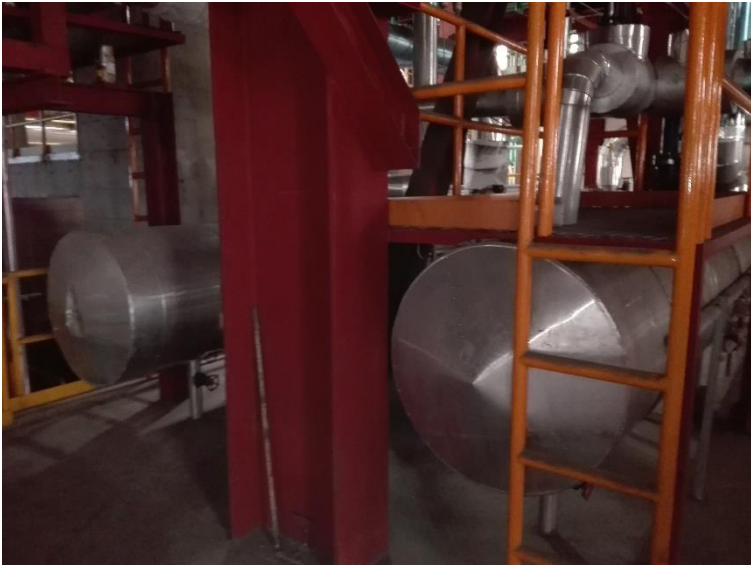
Imagen No. 23. Condensador de la caldera Fotografía: Elaboración propia.
