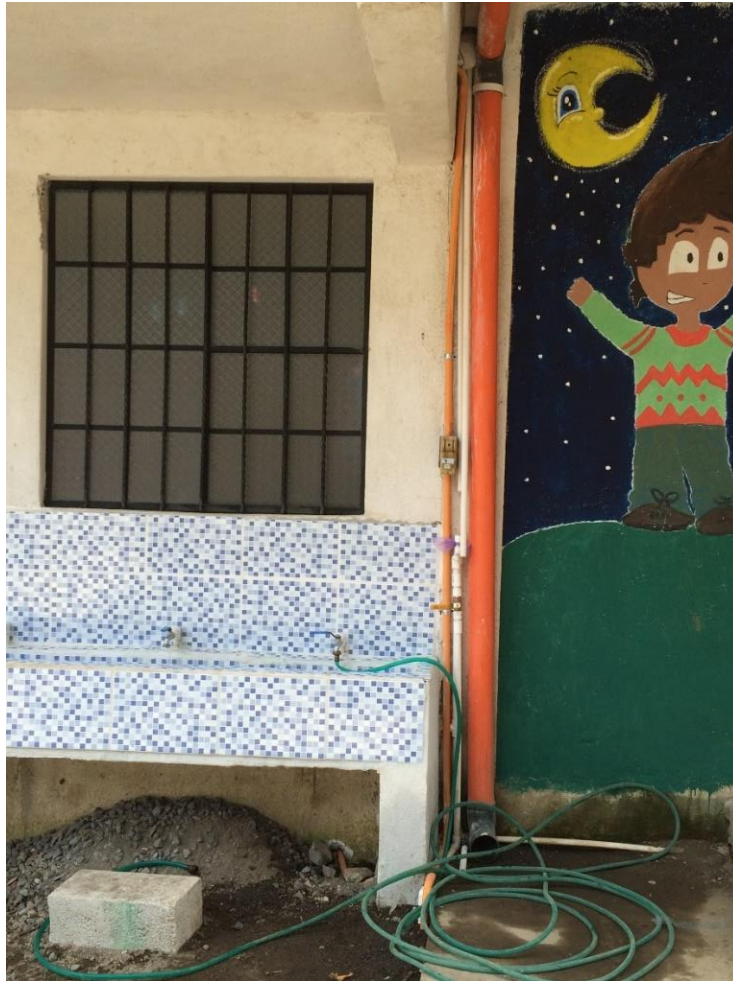
Figura 17. Línea de distribución de agua potable por gravedad (Fotografía: Jezyka Gonzalez)
