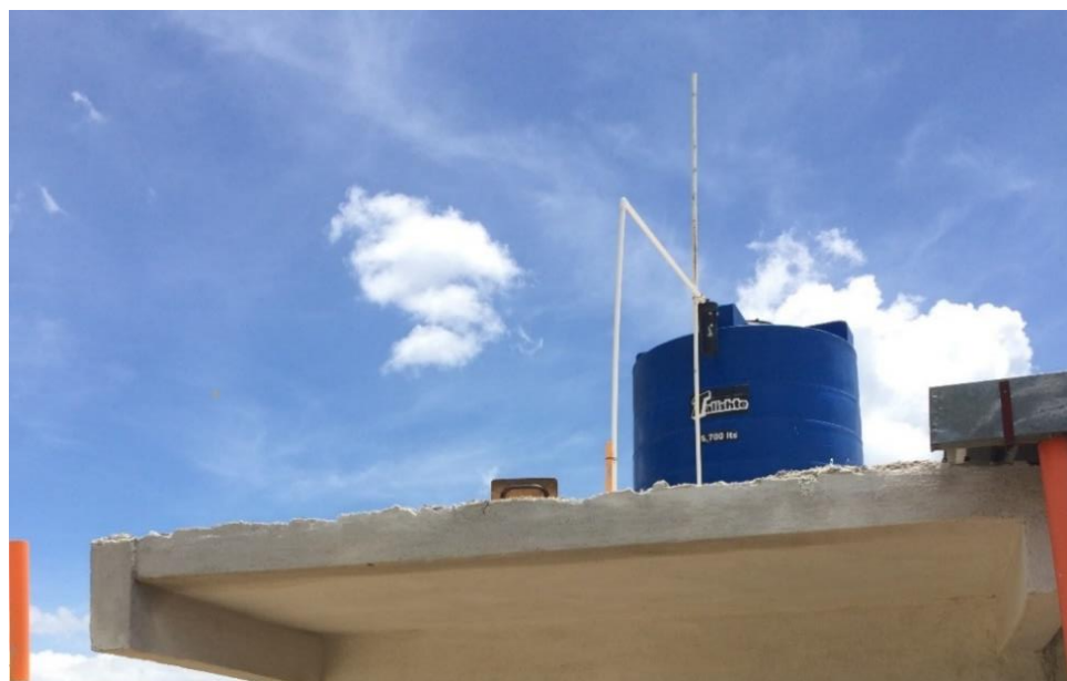
Figura 16. Tanque de almacenamiento de 2,500 litros, filtro y distribución (Fotografía: Jezyka Gonzalez)
