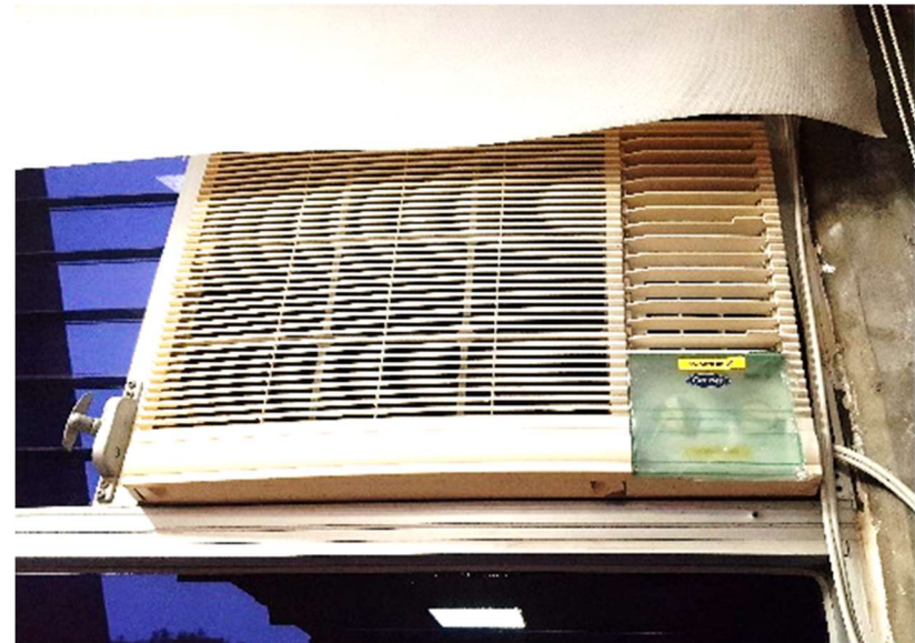
Ilustración 24: Sistema AC unidad de ventana instalado en las oficinas del INDIS, segundo nivel. Fuente: Propia, 2017.
