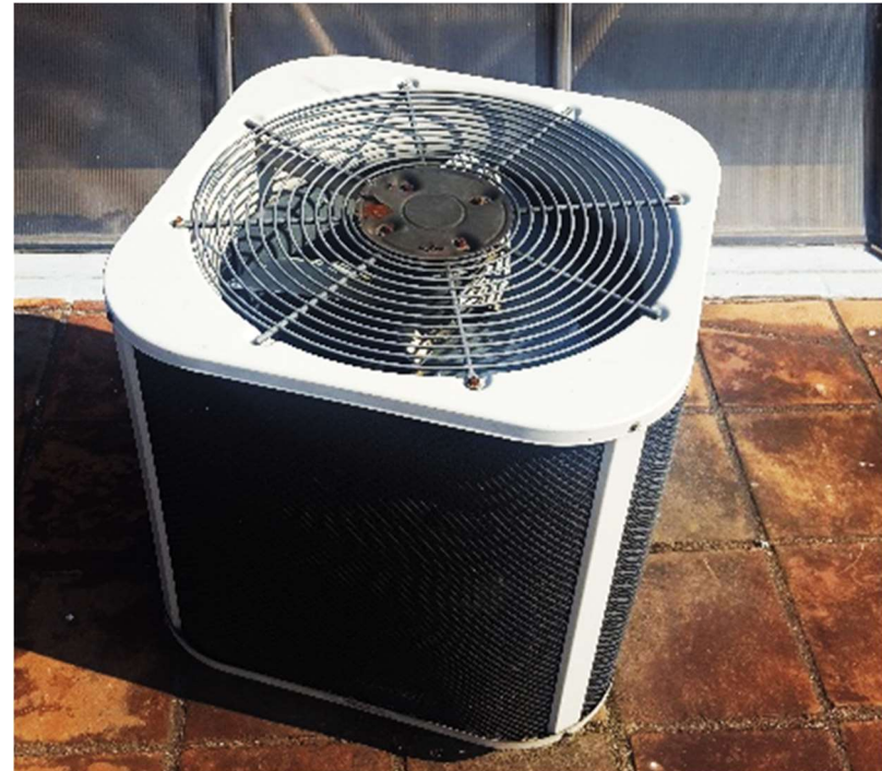
Ilustración 25: Unidad exterior “heat pump” de sistema split interior en sala de reuniones VRIP. Fuente: Propia, 2017.
