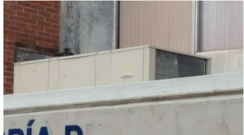
Ilustración 26: Visualización de equipo de AC sobre ingreso principal al edificio “O”, single packaged. Fuente: Propia, 2017.
