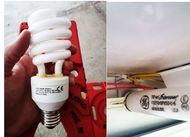
Ilustración 21: Luminarias existentes en el Edificio "O". Fuente: Propia, 2017.
