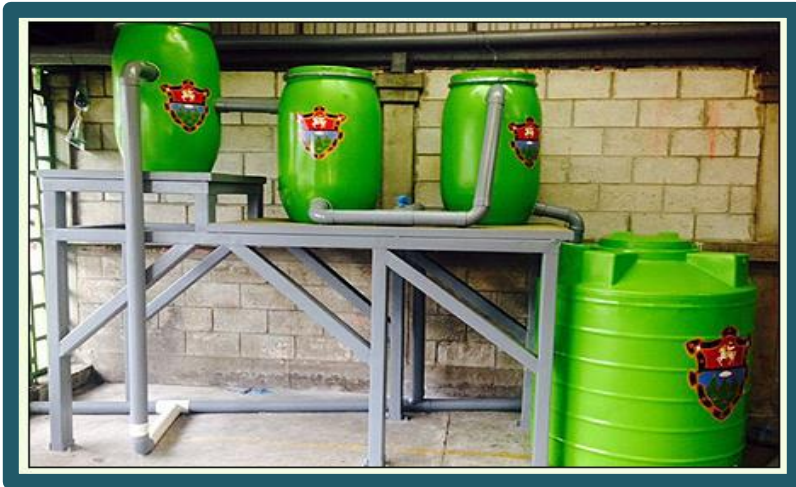
IMAGEN 8. Tanques de almacenamiento de agua lluvia en Mercado Roosevelt zona 11.
