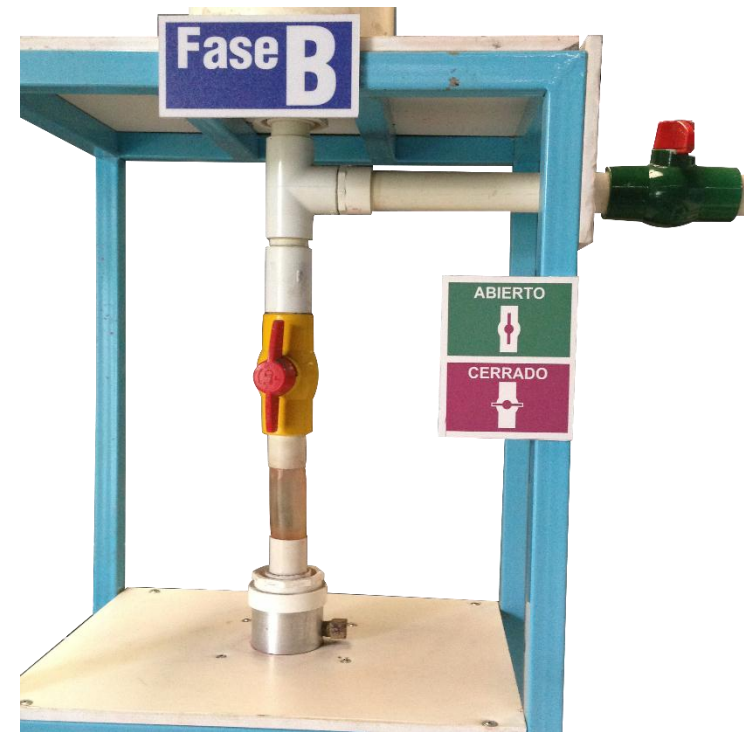
Imagen 12. Pieza T y señalización.
