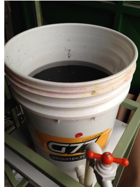
Imagen 15. Fase C, filtro de arena. Fuente: elaboración propia.
