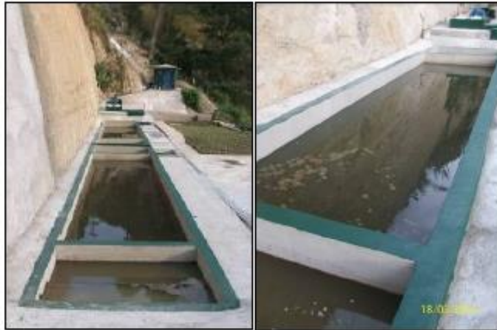
Figura 2. Sedimentador primario de la PTAR de la Universidad Rafael Landívar.
