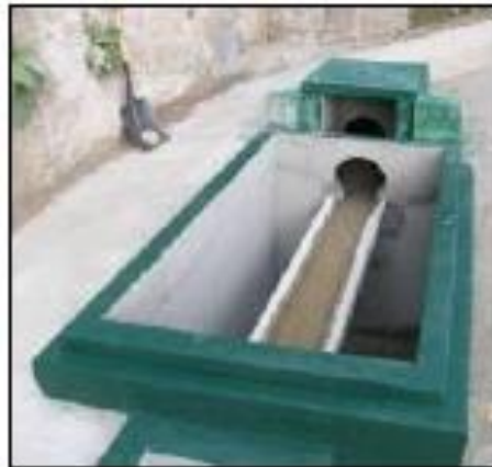
Figura 1. Canal de excedencias de la PTAR de la Universidad Rafael Landívar.
