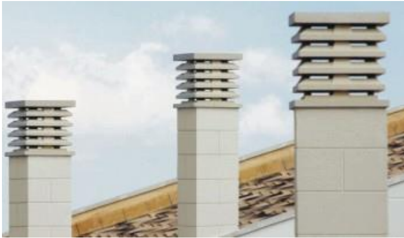
Chimeneas con aspiradores estáticos. Fuente: http://www.lacasadelaconstruccion.es/imagen/acabados-materiales-construccion/aspiradores-estaticos-050101004.jpg
