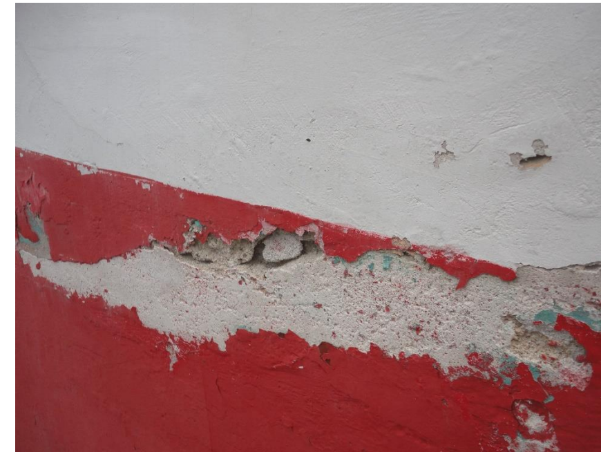
Ilustración 14. Pared con daño por humedad. Fuente: foto propia.
