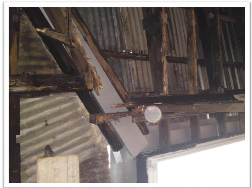
Ilustración 64. Vigas podridas. Foto: A. L. López
