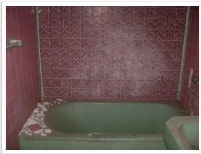
Ilustración 57. Baño en mal estado. Foto: A. L. López
