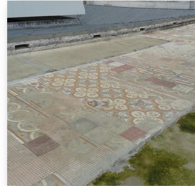
Ilustración 8. Humedad en Sala de conferencias foto tomada en la terraza. Fuente: fotografía propia.
