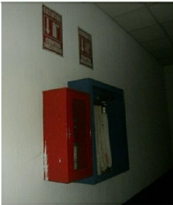
El hospital nacional posee extintores y mangueras en caso de emergencia, con la señalización respectiva.
