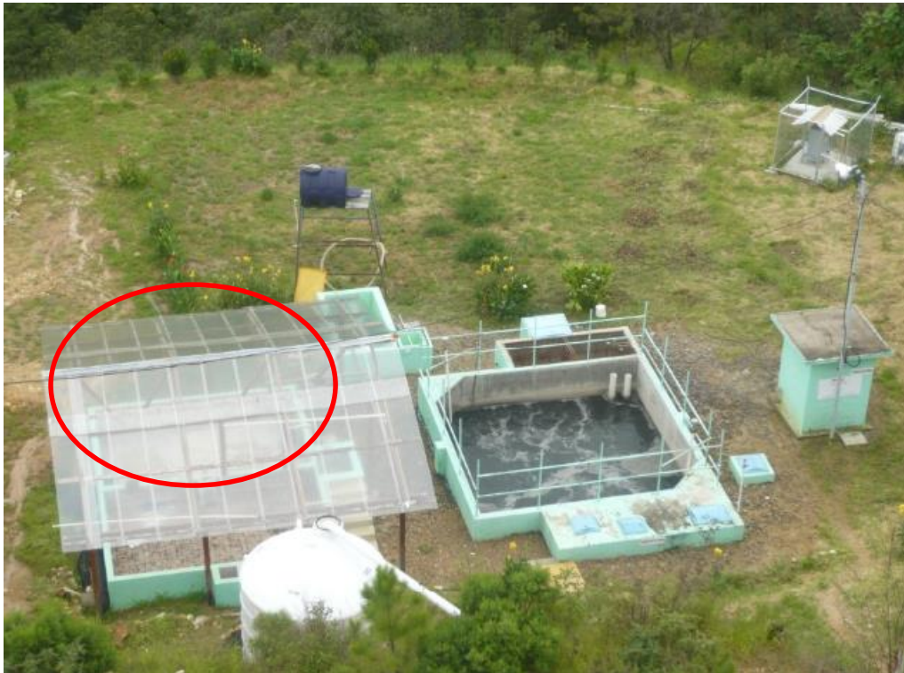
Figura 2 Planta de tratamiento de aguas residuales (Durman) (Quezada, 2013).
