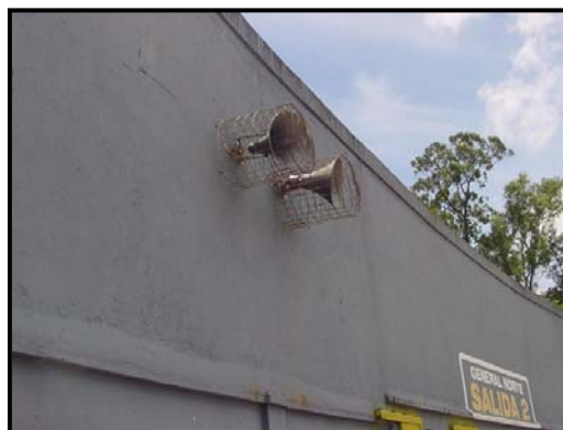
Foto No.52 Bocinas de intemperie
